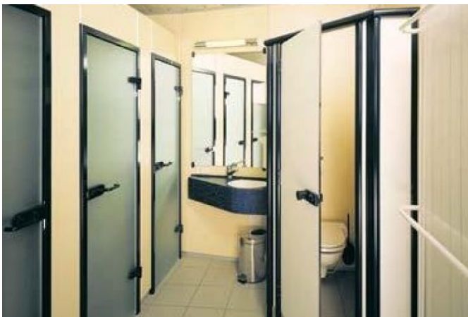
Etagenduschanlagen mit Waschtisch und WC
