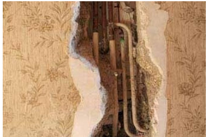
Problemstellung feuchte Wand im Treppenhaus
